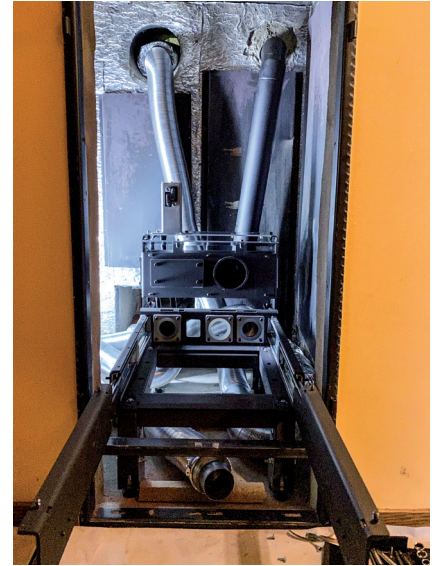
5 Frontansicht - ein Teil der Warmluft wird später unterhalb des Einsatzes in den Raum abgegeben.
