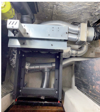
4 Blick auf die Warmluftführung von oben.
