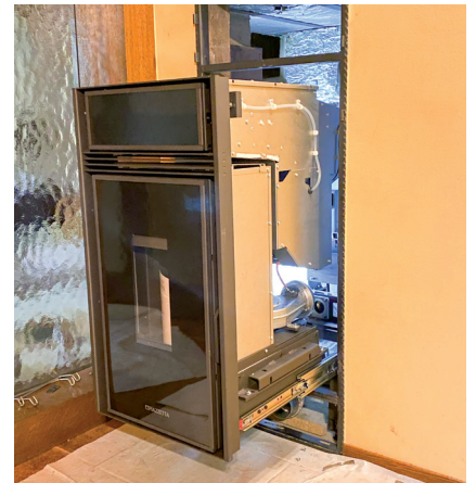
6 Hochzeit – der Pellet-Heizeinsatz wird nun einfach auf das Traglager gesetzt und eingeschoben.
